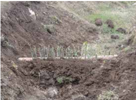
Պատկեր 5. Հարթակների ձևավորում՝ փայտե գերանների ետևի տարածությունները և ուռենու կտրոնները հողով լցնելով
